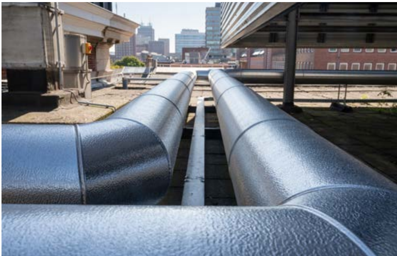
WKO-bronnen van Bezuidenhoutseweg 20 en 30 werden gekoppeld om warmte en koude van deze bronnen optimaal voor beide gebouwen te kunnen gebruiken.
