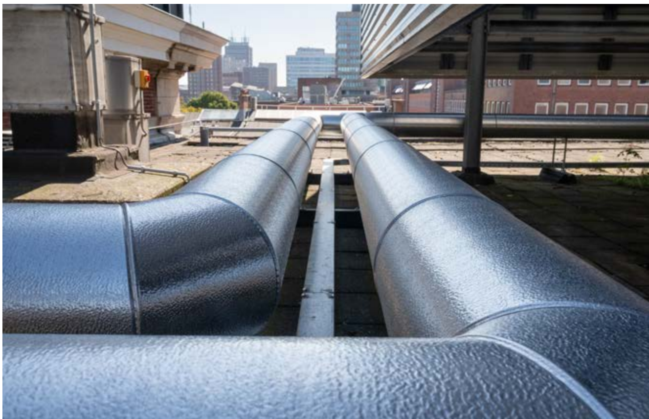
WKO-bronnen van Bezuidenhoutseweg 20 en 30 werden gekoppeld om warmte en koude van deze bronnen optimaal voor beide gebouwen te kunnen gebruiken.
