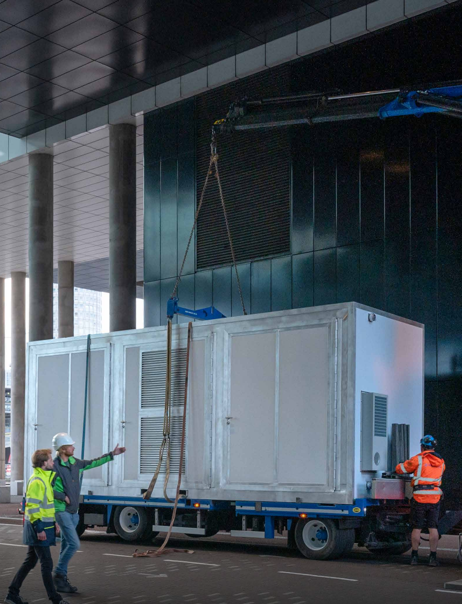
Op 24 oktober 2023 is de Stadsbatterij in de onderdoorgang van Rijnstraat 8 in werking gesteld. ©Rijksvastgoedbedrijf, foto Bas Kijzers
